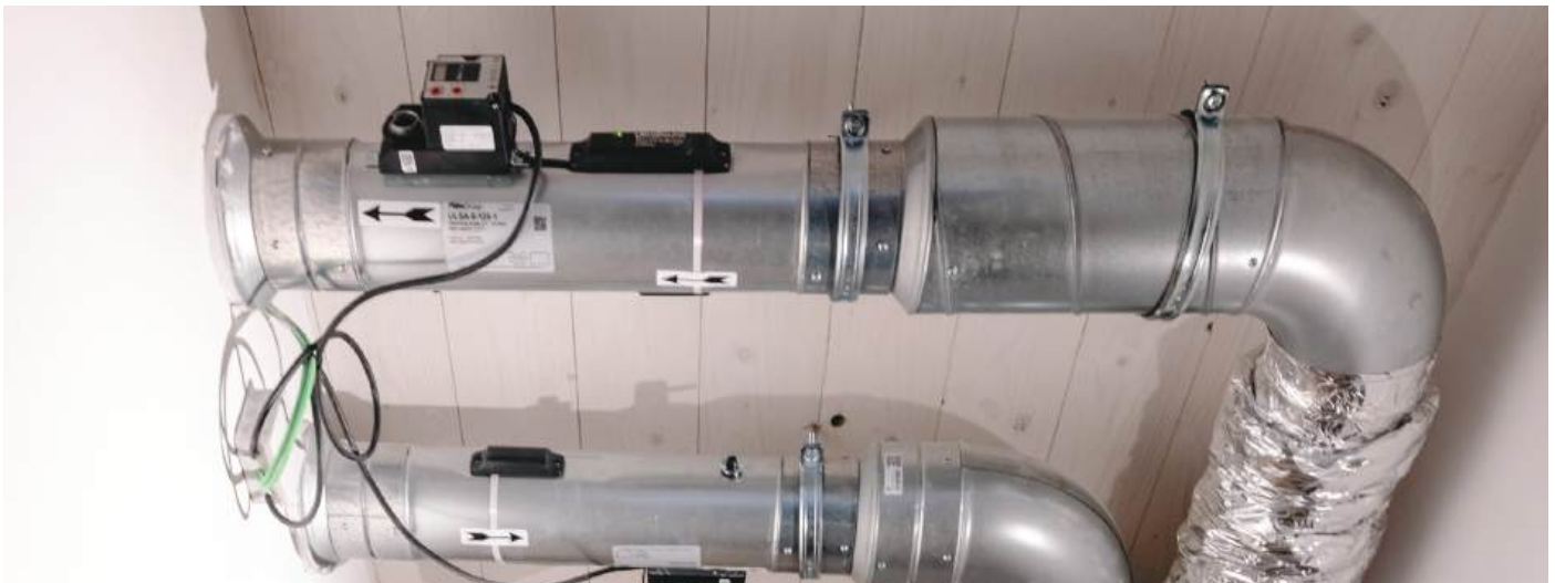
Blijkt uit de CO 2 -metingen dat het ventilatiedebiet in een appartement verhoogd moet worden, dan worden eerst de VAV-kleppen bijgesteld. Enkel indien er zo onvoldoende verversing optreedt, wordt ook het debiet van de centrale luchtgroep opgetrokken.
