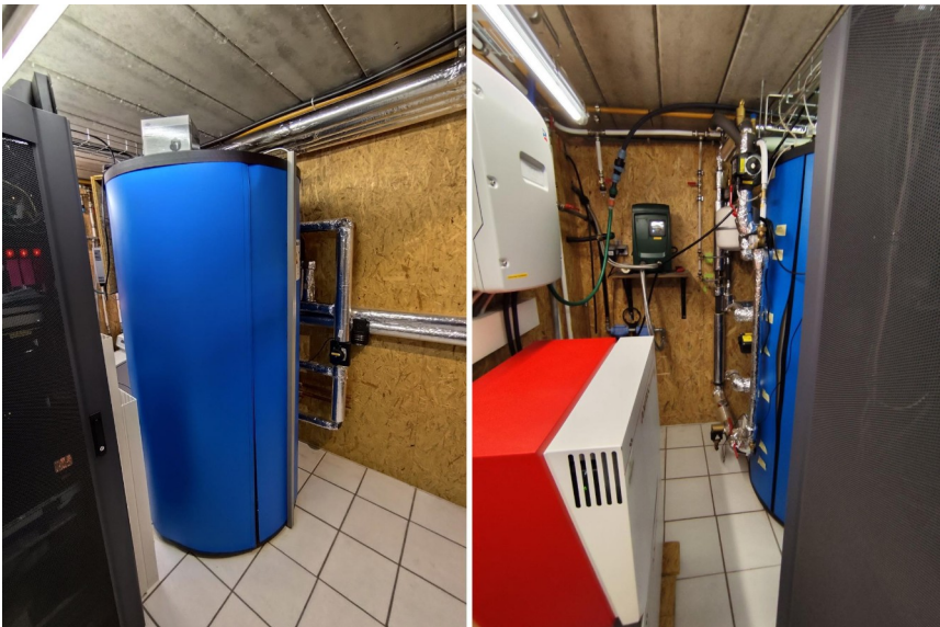
Figuur 1: (links) Buffervat met elektrische weerstand, (rechts) thuisbatterij en omvormer
